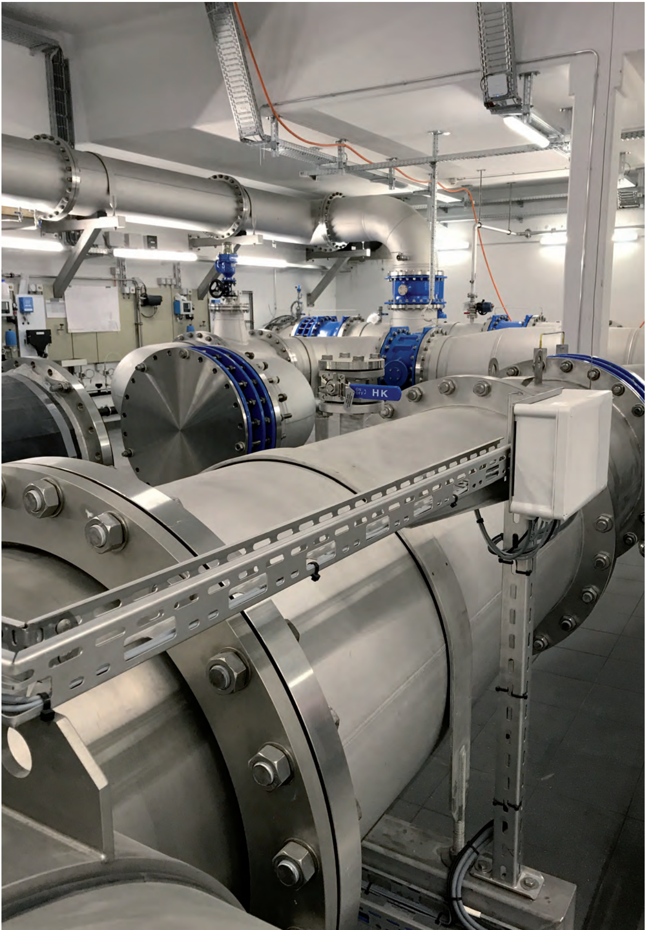
Trinkwasser-Pumpwerk Station de pompage pour de l'eau potable
